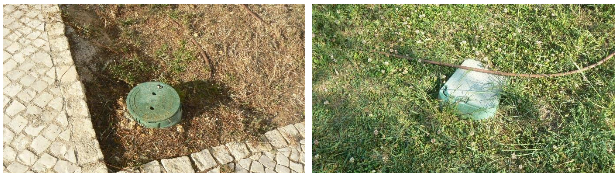
Figura 12. Registo fotográfico do trabalho de campo – Infraestruturas de rega
