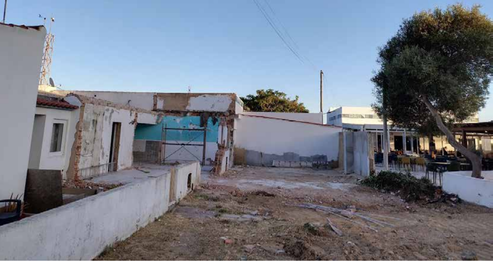
Exemplos dos trabalhos de demolição de estruturas não conformes ao projeto inicial das habitações e de reabilitação que têm estado a ser realizados por iniciativa da Associação. Uma medida necessária à reposição da legalidade do Bairro 1.º de Maio e ao reconhecimento dos direitos dos seus moradores
