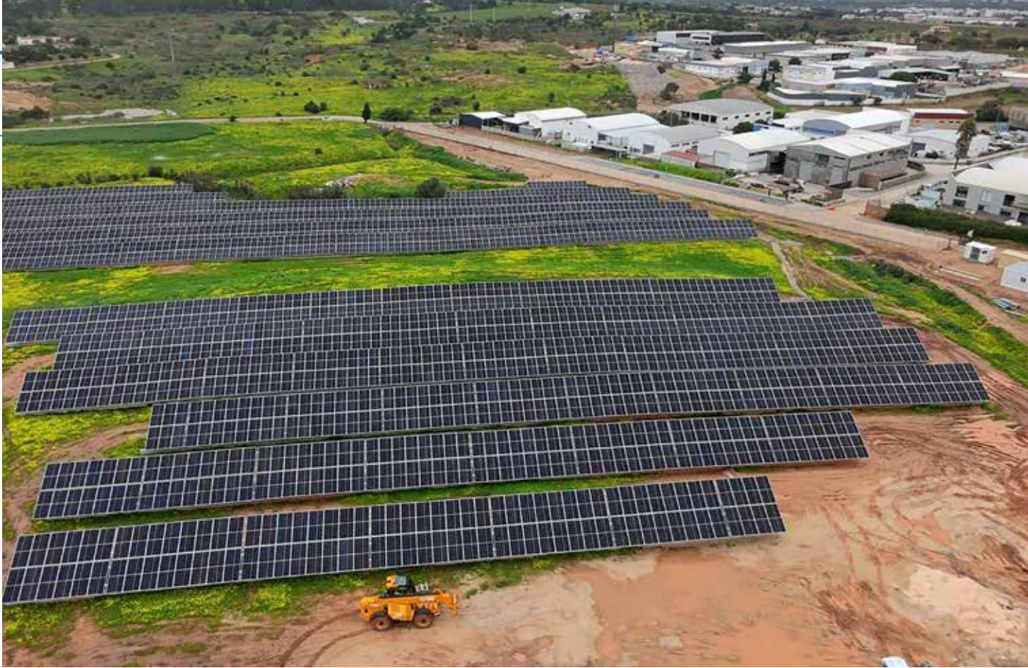
A instalação de painéis fotovoltaicos vai permitir abastecer as áreas empresariais de Lagos
