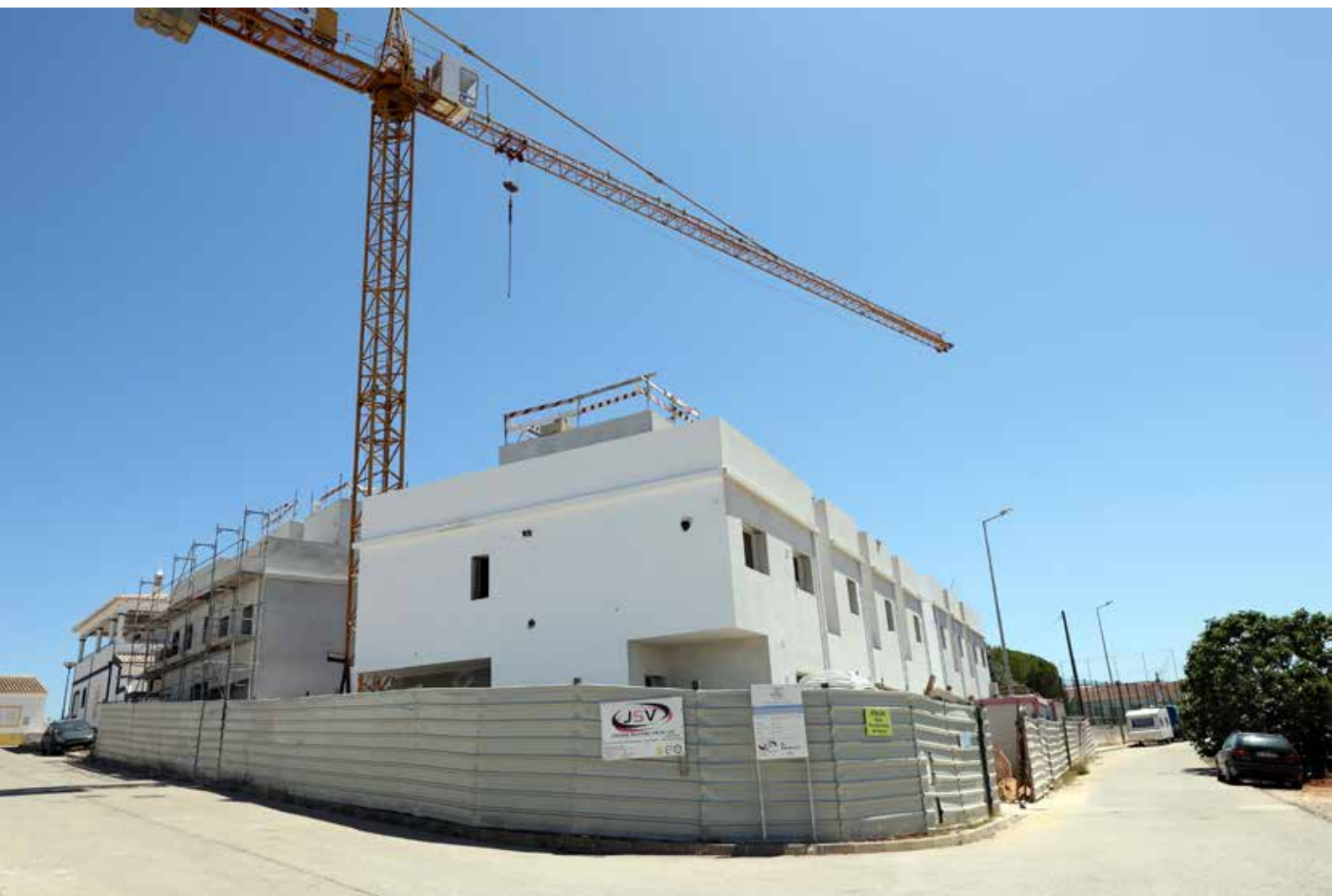
Construção do novo empreendimento habitacional de 9 fogos no Sargaçal (obra em fase de conclusão)
