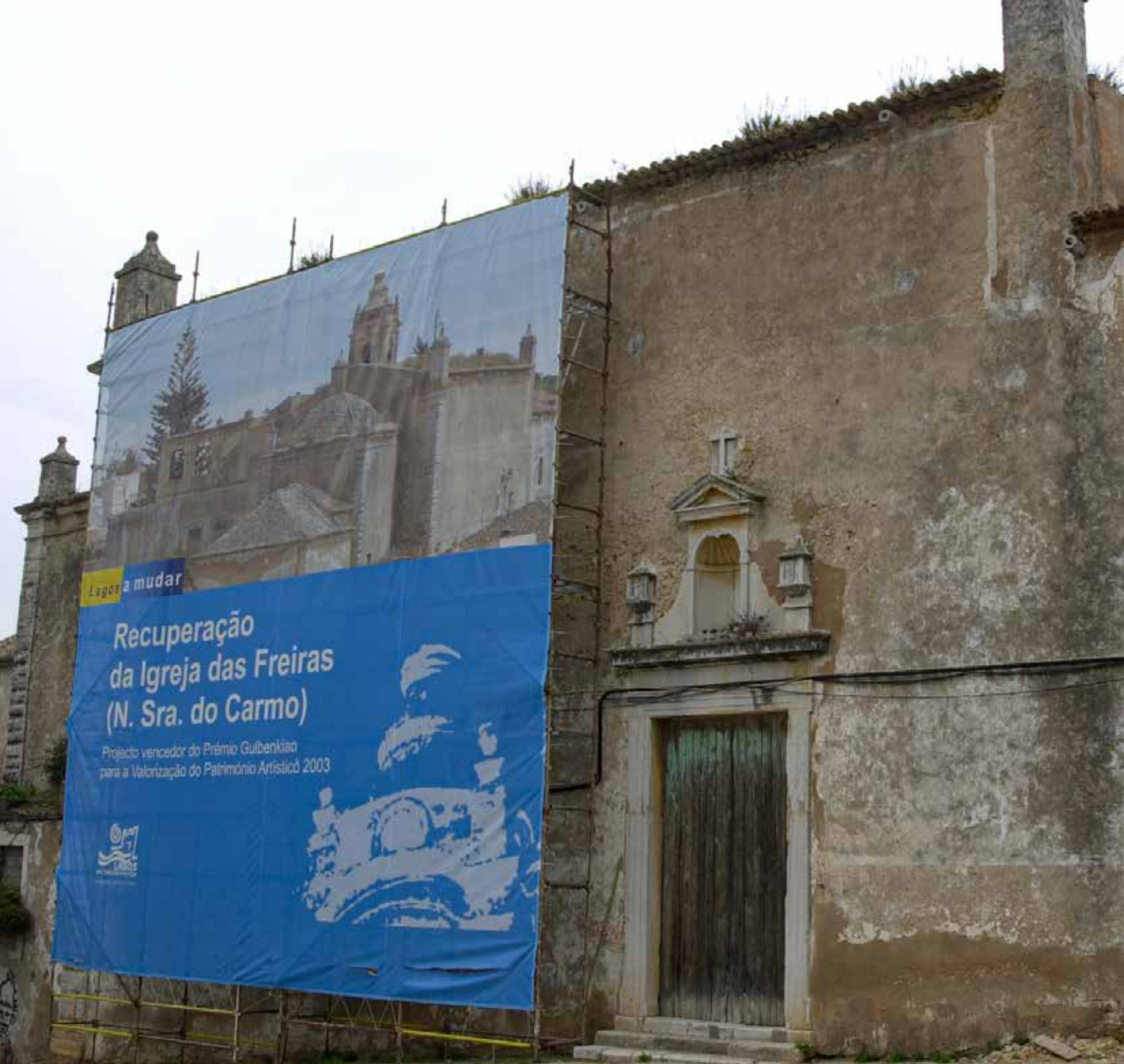
Em cima: A metodologia para a reabilitação da Igreja foi distinguida com o Prémio Gulbenkian para a Recuperação e Valorização do Património. Em baixo: A intervenção inicial incluiu trabalhos de arqueologia.
