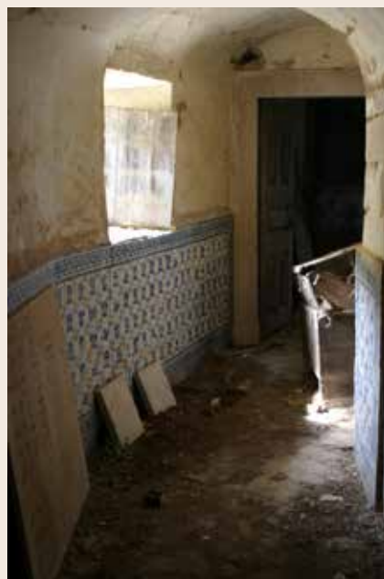
Todo o interior estava ao abandono e degradado
