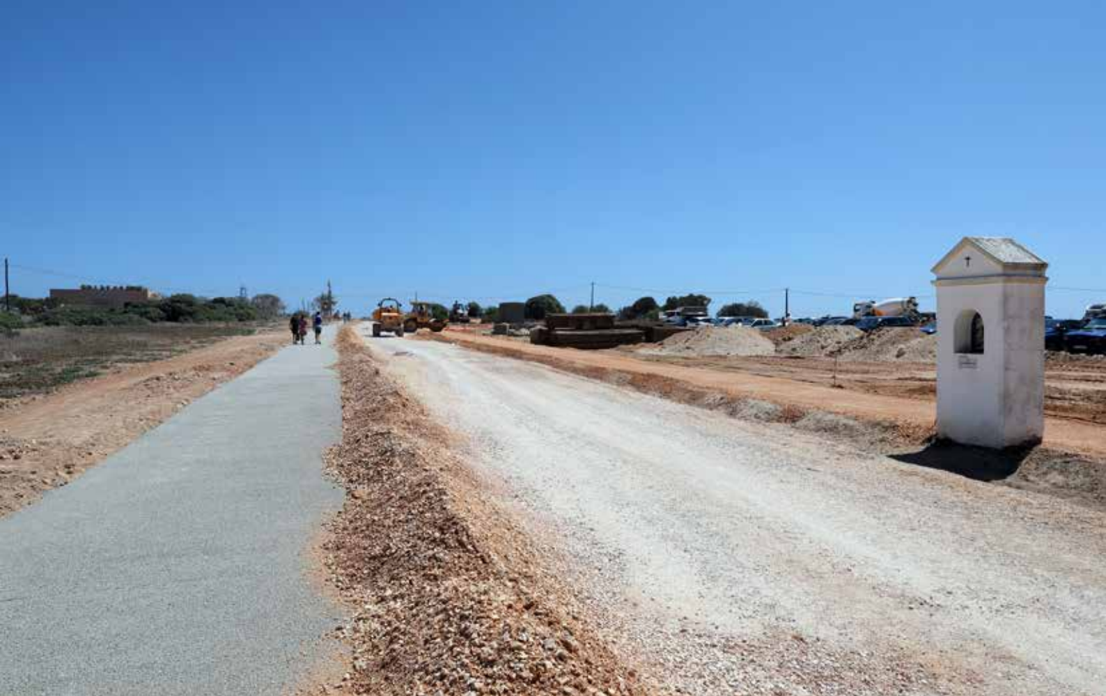
As obras da 2.ª fase de Requalificação da Ponta da Piedade (componente 2) irão melhorar as condições de circulação pedonal e ciclável.
