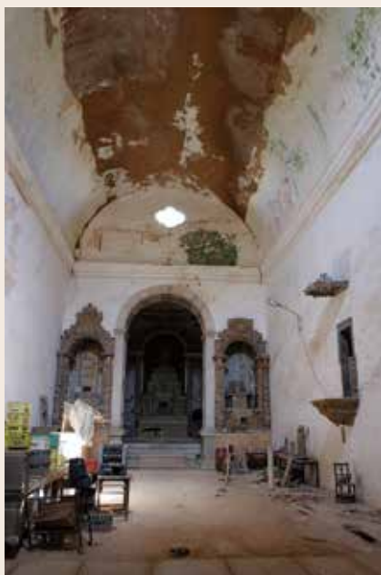
No interior, o risco eminente de colapso suscitava especial preocupação
