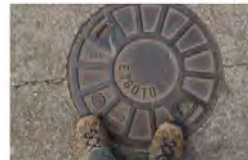
Caixas de Esgoto
